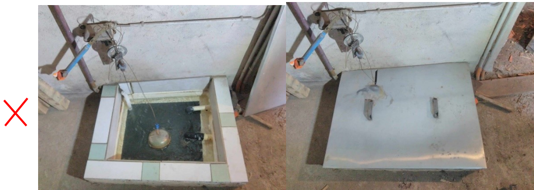
Trou d'homme inox dans la chaufferie.
